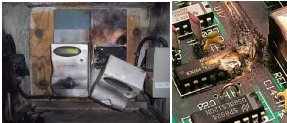
Fig. 2.6 – Evidenza di danni da sovratensioni causati dal fulmine
